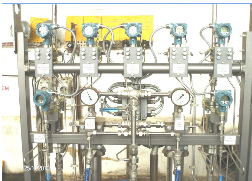
Рисунок 1 – Общий вид стойки управления СГДУ
